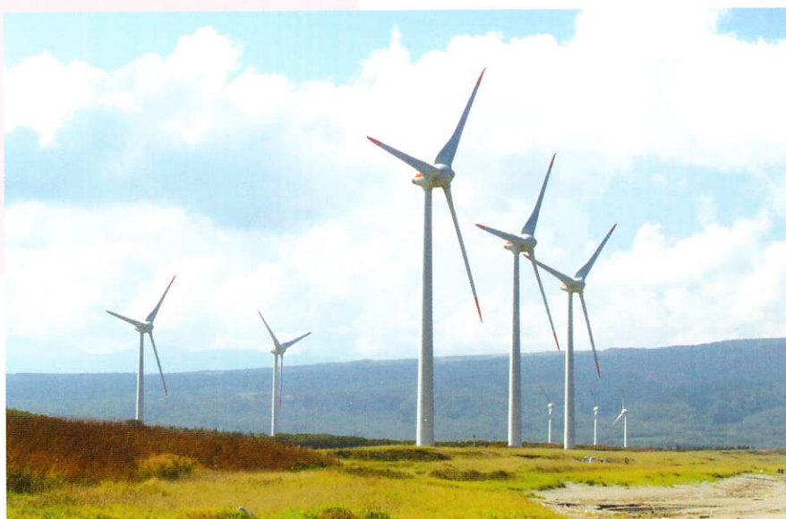
北海道南西部に位置する寿都郡寿都町の「寿の都風力発電所」
